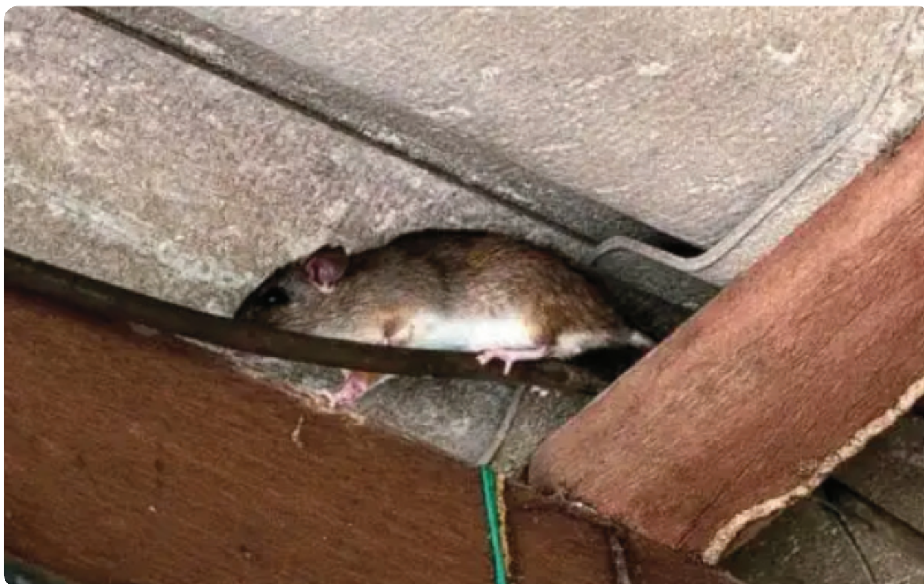
Figura 13: Rato-de-telhado em fiação de telhado no ambiente urbano.
