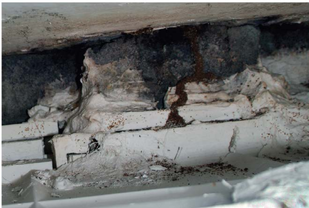
Figura 14: Danos causados por cupins da espécie C. gestroi em vão do forro em teto de banheiro de apartamento na cidade de São Paulo – SP.
